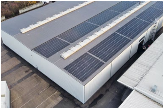
2022 am Standort Lauingen installierte Photovoltaikanlage.
