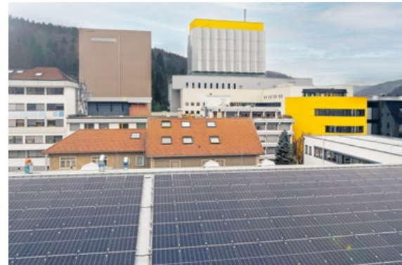
2022 am Standort Stühlingen installierte Photovoltaikanlagen (1/2).
