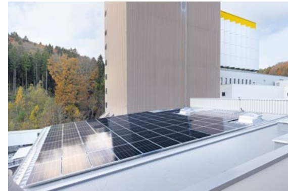
2022 am Standort Stühlingen installierte Photovoltaikanlagen (2/2).
